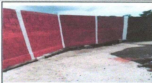
Foto 1: Pintura en el interior del muro perimetral.
